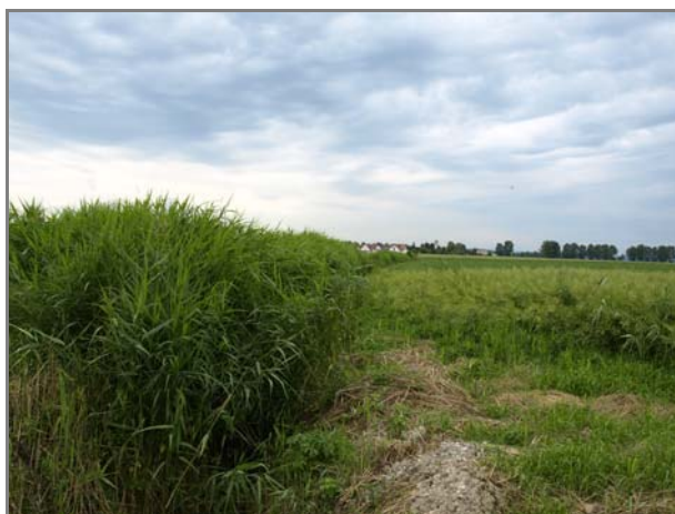
Fot. 32. Konieczna konserwacja rowu R-B1.
