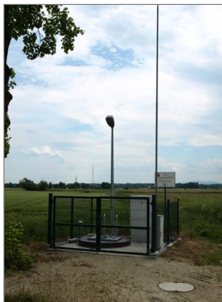
Fot. 11. Pompownia ścieków w Tomkowicach.
