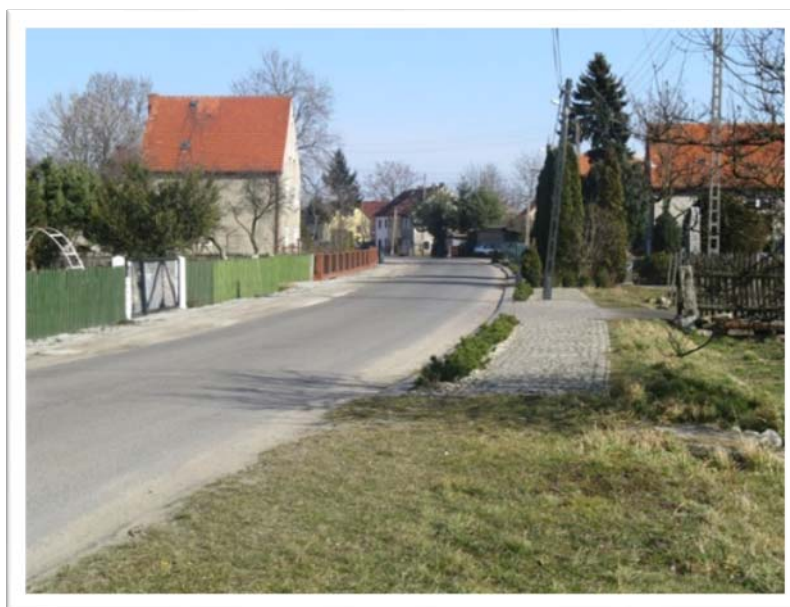
Fot. 21: Niedokończony chodnik z nieprzełożonym słupem telefonicznym.
